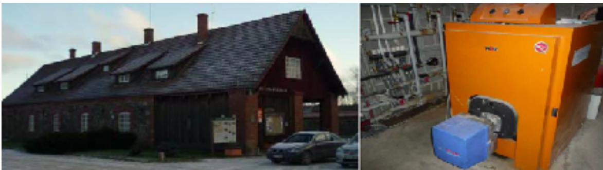
Vierastalo ja sen lämmitykseen käytettävä öljykattila
